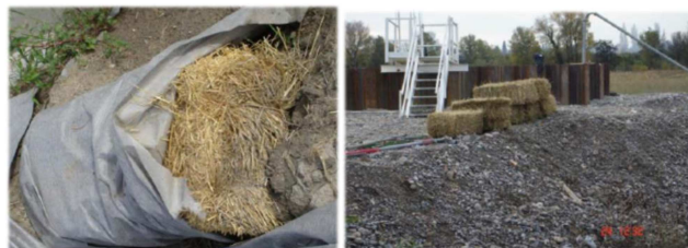
Illustration 42 : Filtres à pailles (Source photo : CETE)
